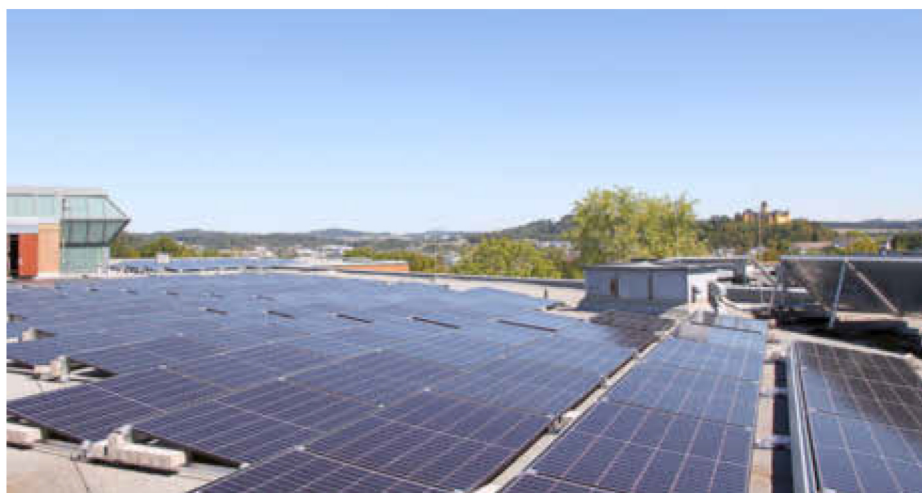
Die Fotovoltaik-Anlage auf der BBS in Montabaur ist eines der vielen zukunftssträchtigen Projekte, die der Kreis in den Ferien an den Schulen umsetzt
